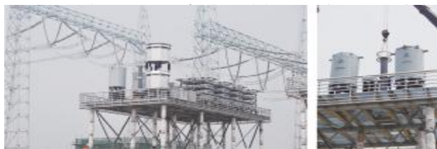
图 1 晋东南—荆门 1 000 kV 特高压输电线路 南阳站串联电容器补偿站
